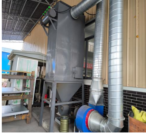
图 2-5 切割粉尘布袋除尘器
