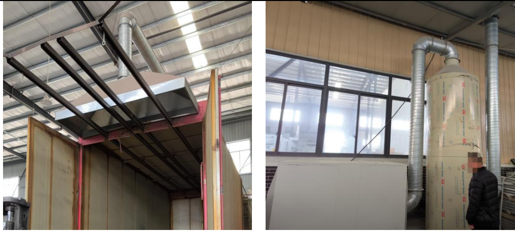
图 2-8 固化废气收集处理措施
